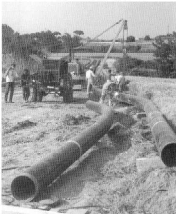
Les obres per l'arribada del gas a Osona es realitzen a bont ritme.
