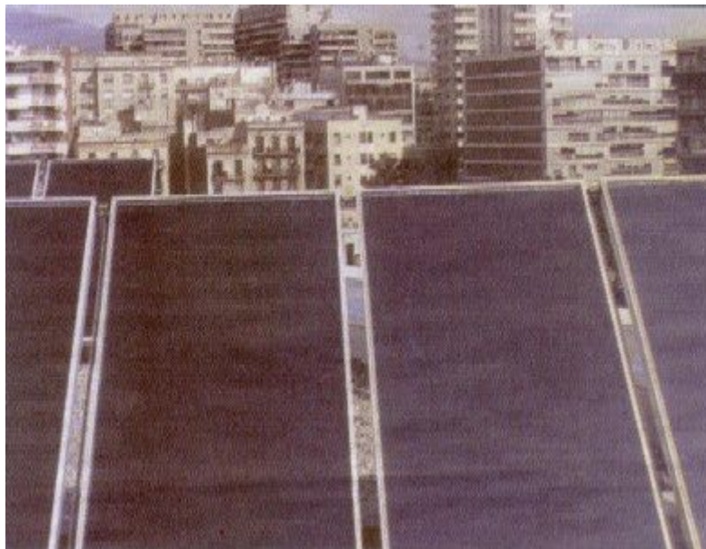
Plaques fotovoltaïques instal·lades al terrat d'un edifici de Barcelona
